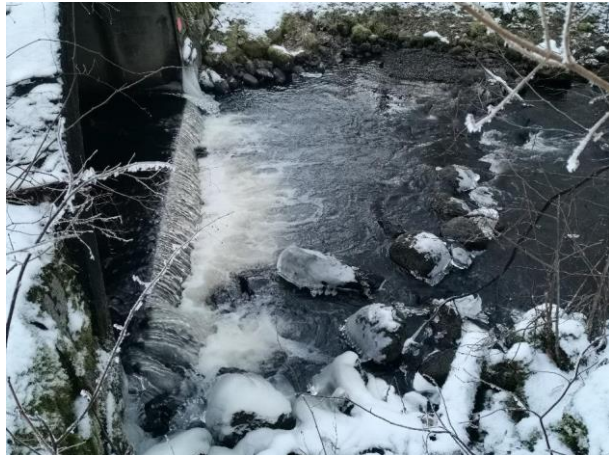
Utloppet ur vägtrumman den 29 december 2018. Fortfarande är det att ca 30 cm högt fall som utgör vandringshinder för fisk vid låglöden och för andra fiskarter än öring och övrig akvatisk biota.
